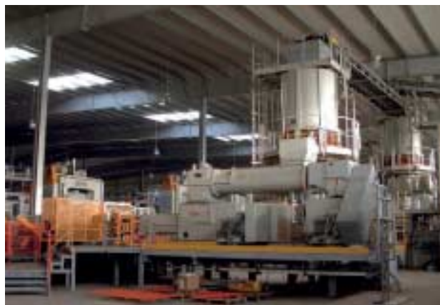
»7 Batzenformgebungsanlage »7 Slab shaping plant
