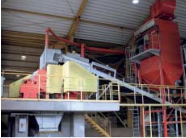
»5 Schwingenwalzwerk mit Anschluss an die Entstaubungsanlage »5 Hinged-type fine roller mill with connection to dust-extraction system
