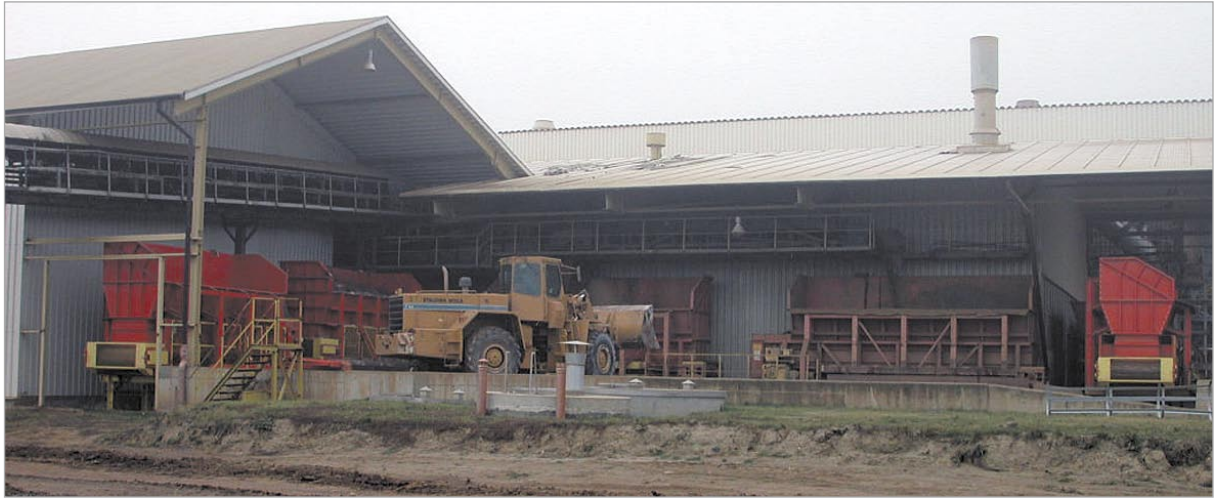
HÄNDLE Beschickungs- und Dosieranlagen für Rohton vor der Aufbereitungsanlage eines polnischen Ziegelwerks.
