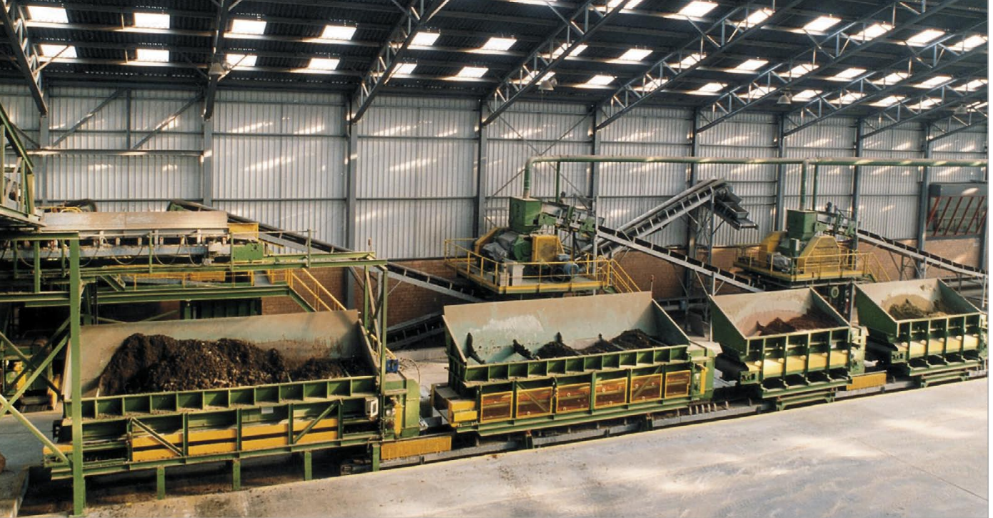
HÄNDLE Beschickungs- und Dosieranlage, vor der Aufbereitungsanlage eines belgischen Ziegelwerks.
