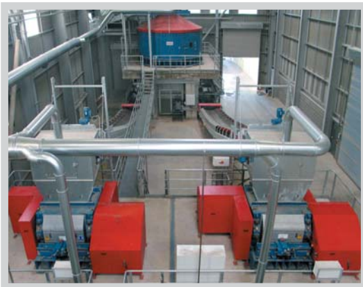
Zwei Walzwerk-Linien mit Beta-Walzwerken der Type WF 10120e, eingesetzt als Vorwalzwerke
